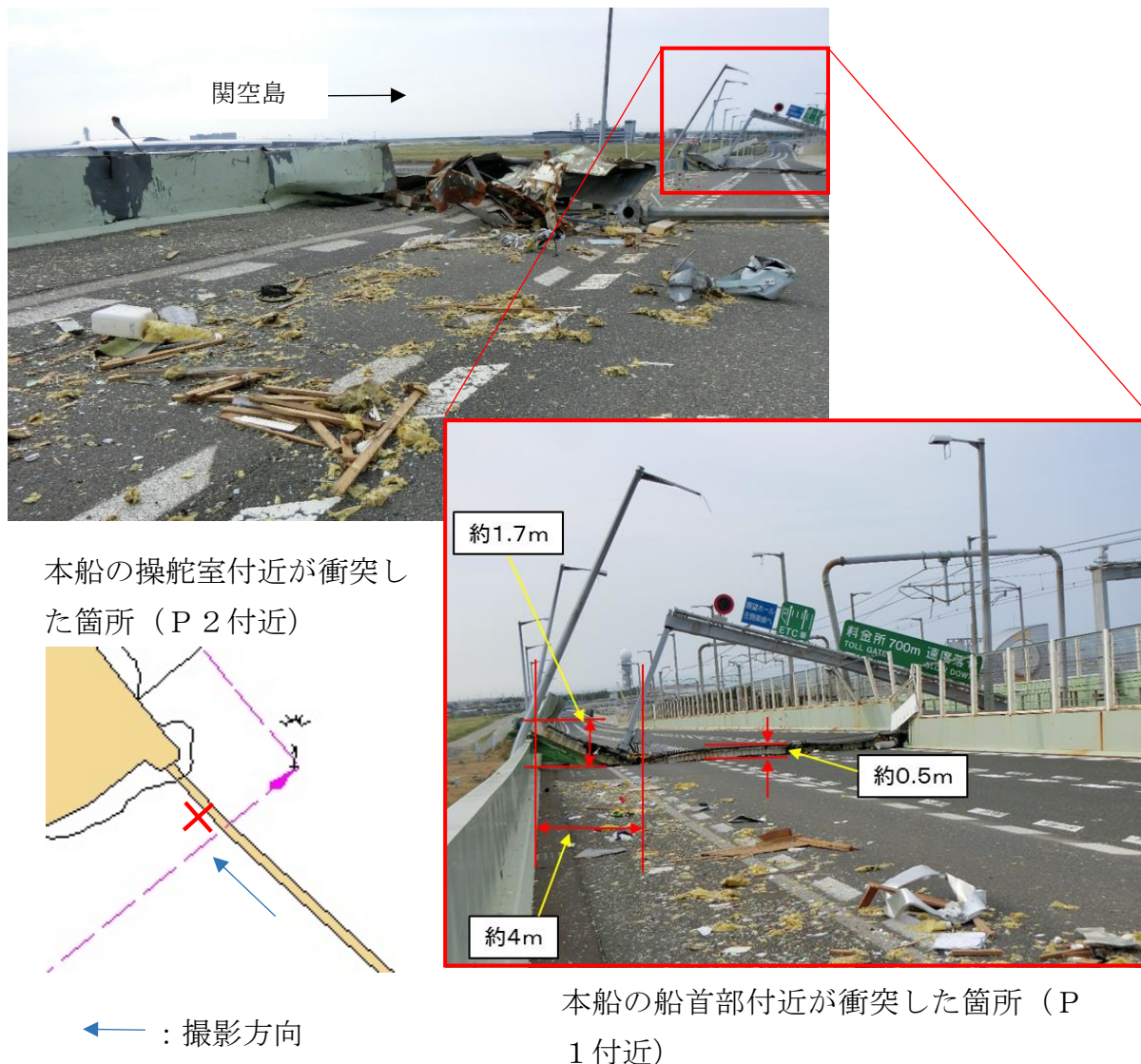
図6 本件連絡橋上の損傷状況
