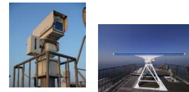
<監視カメラ> <レーダー>
