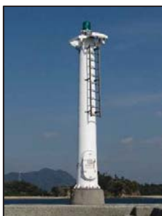
アンカーボルト露出
