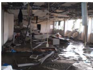
執務室の被災状況
