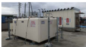
宮城巡視艇用燃料タンク
