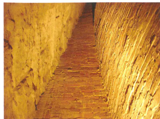
内部から見た「二重殻複合構造」の様子 向かって右側がレンガ積壁、左側が石積壁。プラントンが建設した犬吠埼灯台・尻屋埼灯台はレンガのみによる「二重殻構造」です。
