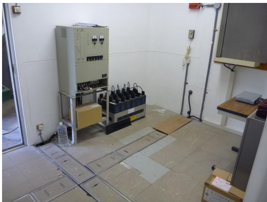
【M型点灯制御装置と蓄電池】
