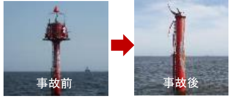
走錨船舶の接触による損傷（灯標の上部脱落） ※過去5年間における船舶接触による航路標識の被害件数 計262件
